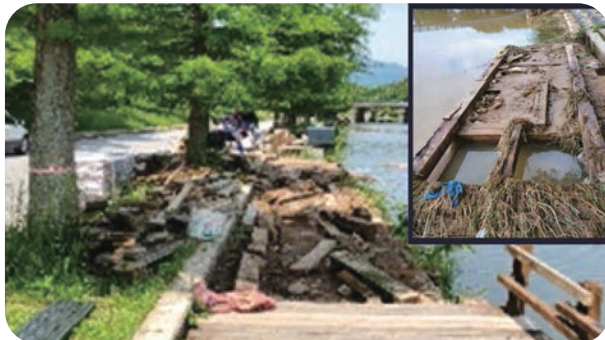
폭우로 인해 파손된 목재데크
